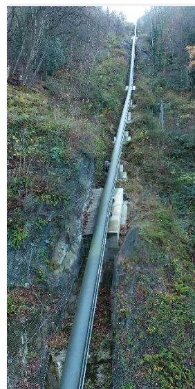
Conduite forcée du Lac Mort
